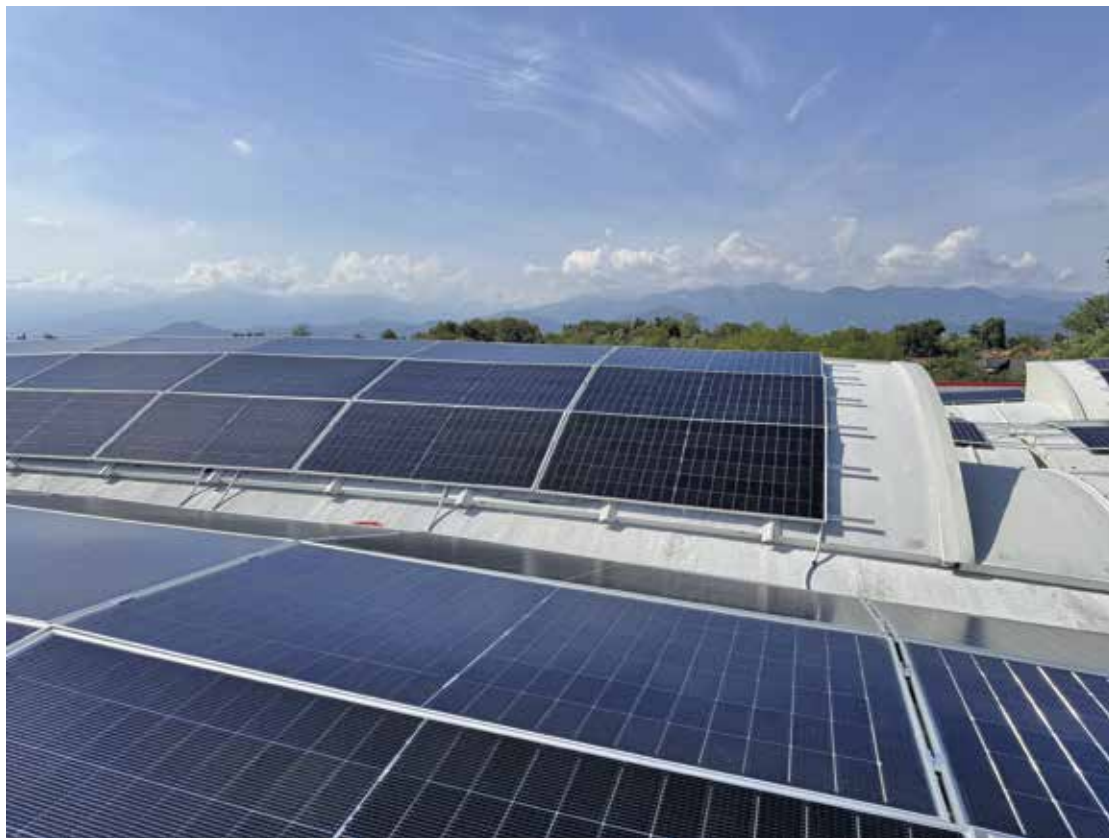
Impianto fotovoltaico realizzato per Hydromec.
